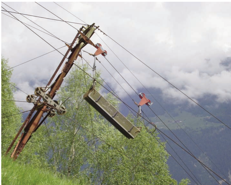
Seilbahn beim untersten Masten
